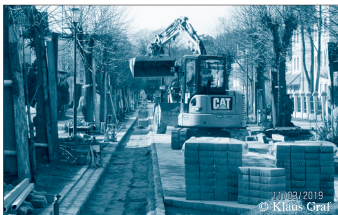
Umbau der Kurstraße. Rechts und links ein Radweg, in der Mitte die Fahrspur für die Einbahnstraße.
